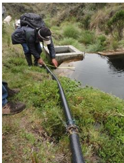
Foto 12 Aducción del sistema de abastecimiento
