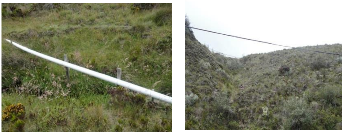
Foto 15 Conducción y red de distribución del sistema de abastecimiento
